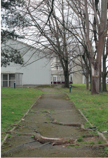
Cheminement en fond de parcelle - état de la chaussée
